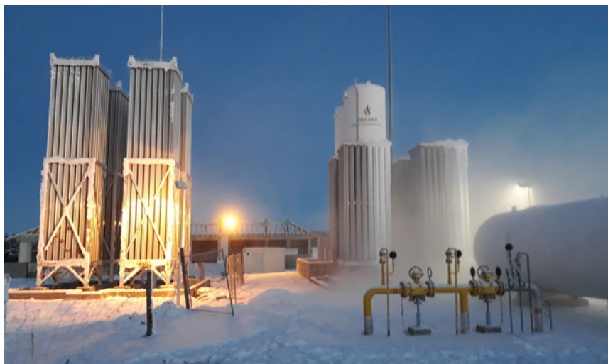
Stacja LNG Suwałki – po rozbudowie, fot. archiwum Polska Spółka Gazownictwa Sp. z o.o.
