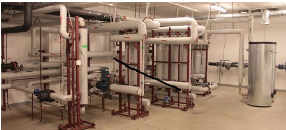
Węzeł ciepły, fot. archiwum PEC w Suwałkach Sp. z o.o
