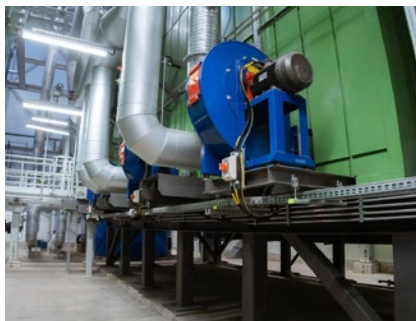
Palenisko kotła biomasowego, fot. Archiwum PEC w Suwałkach Sp. z o.o
