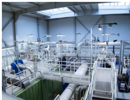
Instalacja spalania biomasy, fot. Archiwum PEC w Suwałkach Sp. z o.o
